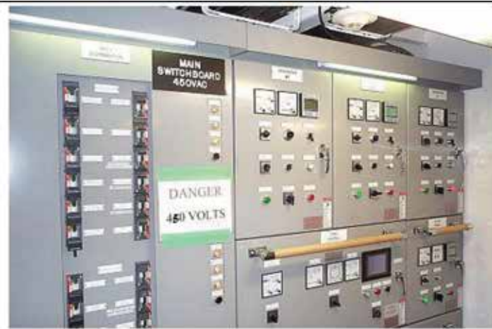
Technicien en électricité
